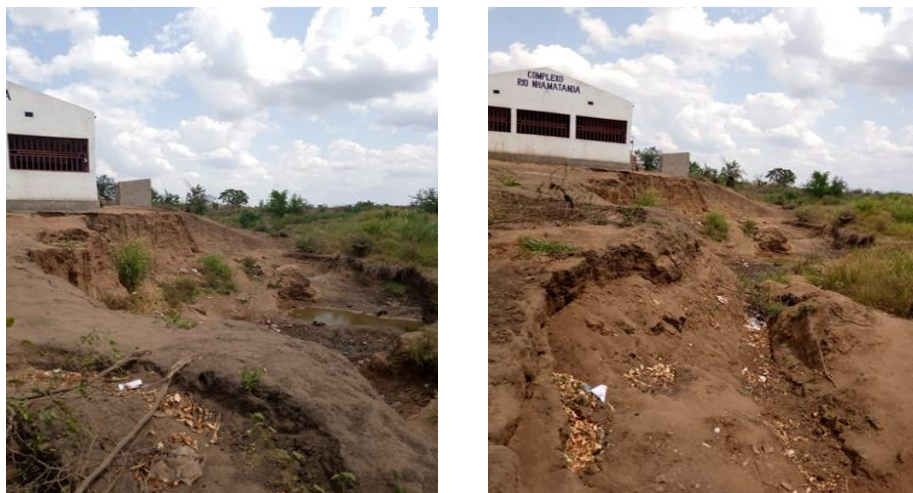
Fotografia 5: Exemplo de erosão acentuada no bairro Eduardo Mondlane, complexo Nhamatanda
