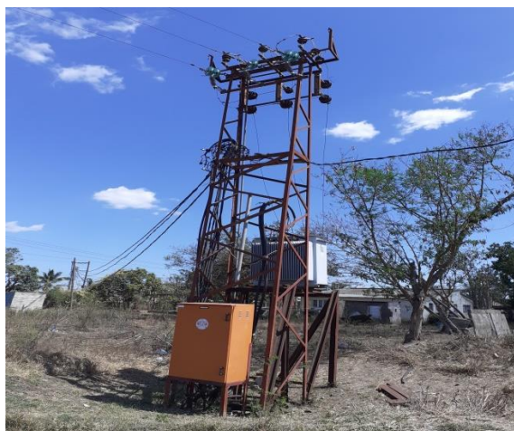
Nhamatanda – PT em pórtico de ferro MT/BT
