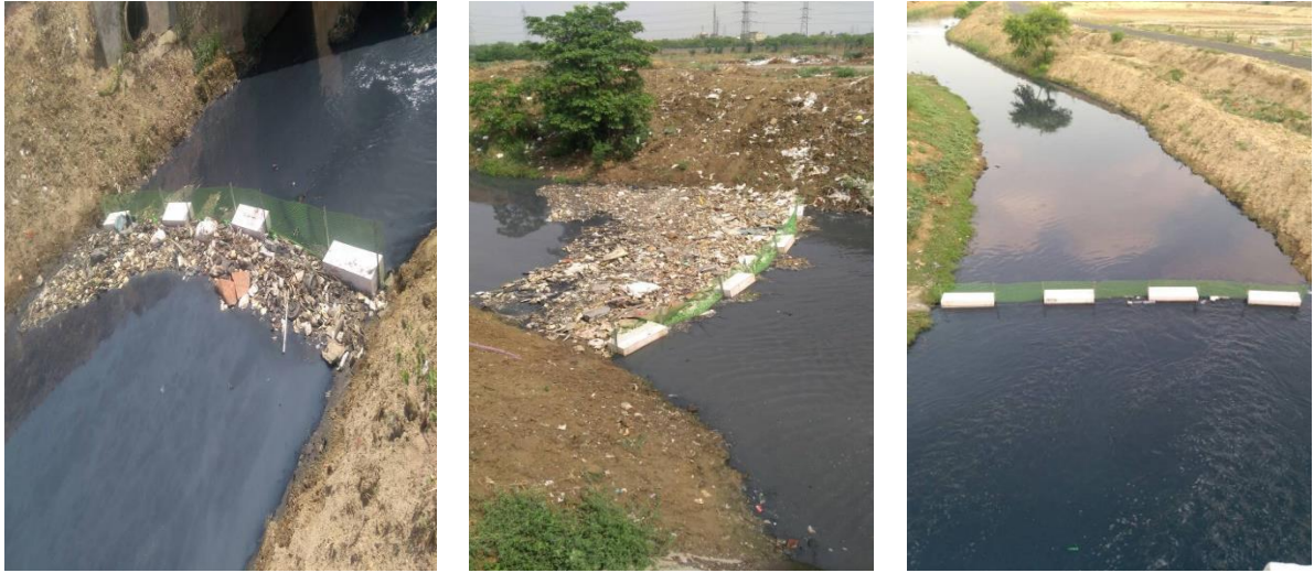
Fotografia 2: Estrutura para retenção de resíduos sólidos em canais
