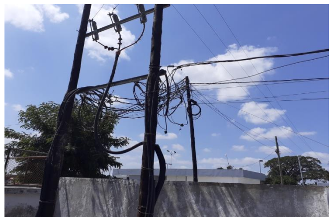
Chegada em MT e saídas em BT no PT-1
