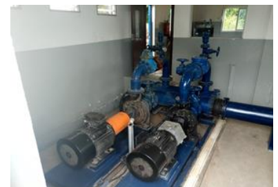
Bombas (1xGrundfos NK150-315/305 - Q=351 m 3 /h; H=30m), 1483 rpm+1 x Grundfos NK125-315/295 - Q=250 m 3 /h; H=25 m, 1479 rpm)
