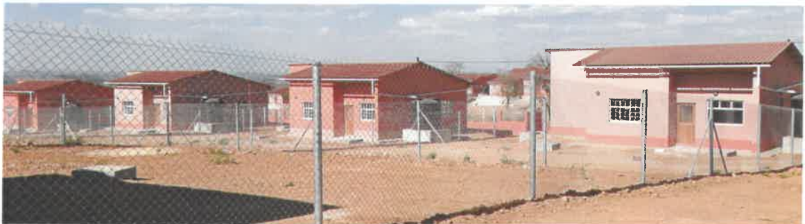
Construção de 48 Casas no âmbito de Reassentamento das Famílias Afectadas pela nova Ponte de Tete
