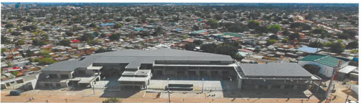
Construção do Centro Comercial Designado “Caniço Shopping”, Compoene, Bairro Polana Caniço A, Maputo
