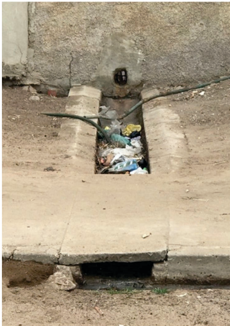
Figura 5-8: Esgoto doméstico sobre a via
