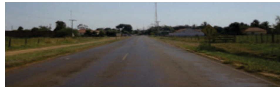
Figura 4-9: Exsudação do ligante do revestimento. Fonte: DER/SP
