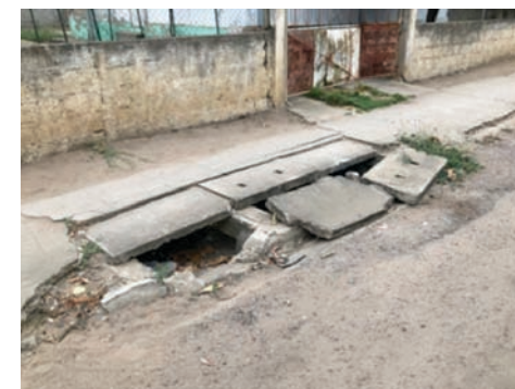
Figura 5-9: Destruição de sarjeta
