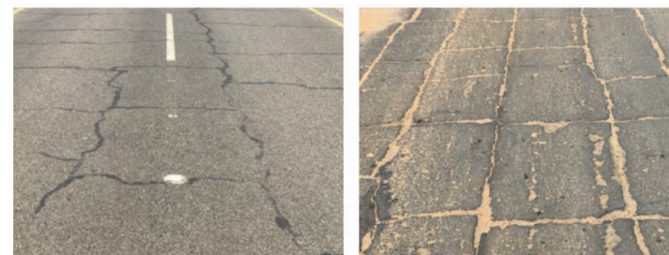
Figura 4-22: Fissuras em bloco
