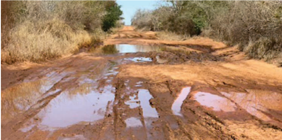
Figura 4-59: Secção de estrada sem geometria adequada e sem drenagem
