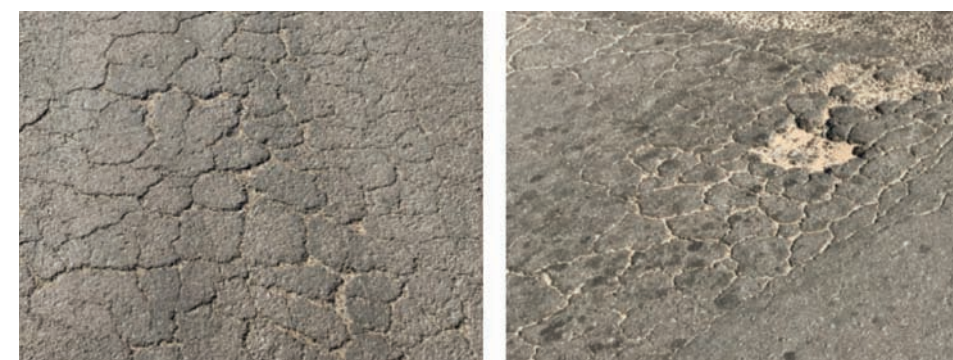
Figura 4-19: Fissuras do tipo pele de crocodilo
