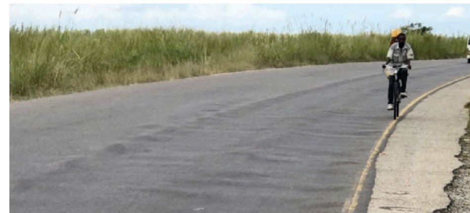
Figura 4-13: Corrugações/Ondulações em pavimentos asfaltados
