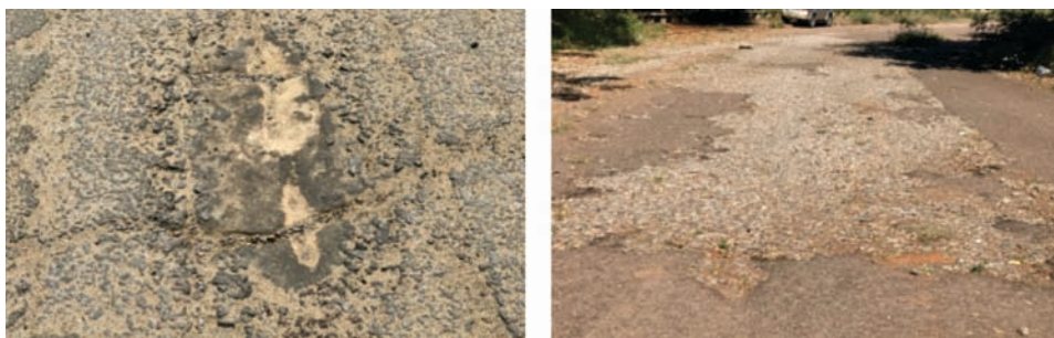
Figura 4-3: Desagregação da superfície
