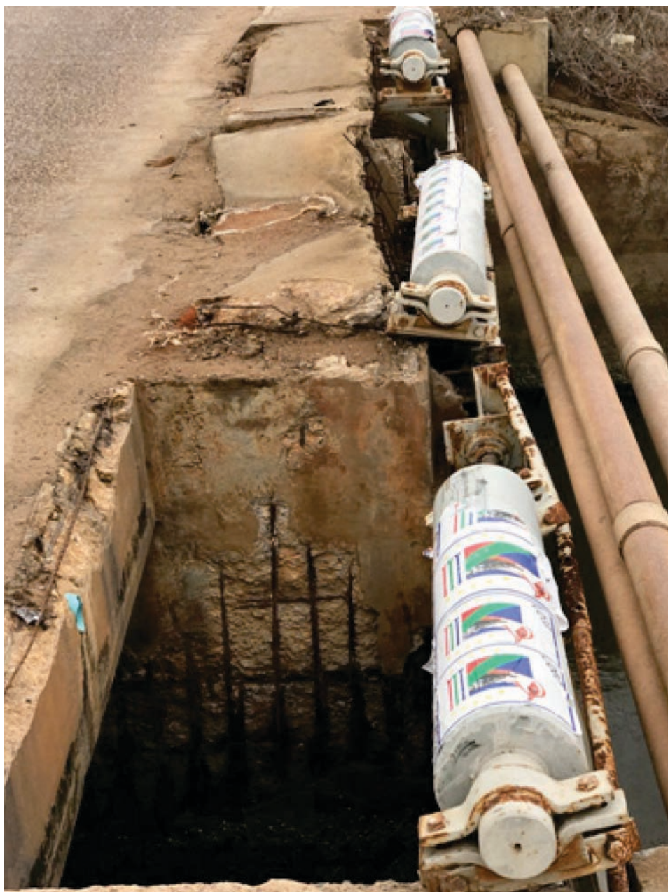
Figura 5-5: Ausência de manutenção
