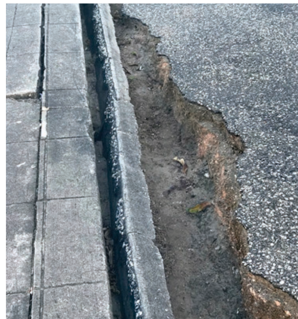
Figura 5-11: Ausência de manutenção
