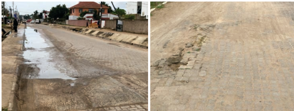
Figura 4-37: Deformações alongadas na superfície do pavimento de pavê
