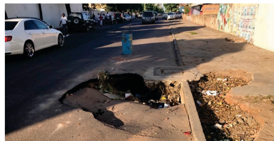
Figura 5-6: Falta de intervenção atempada das instituições de tutela dos serviços
