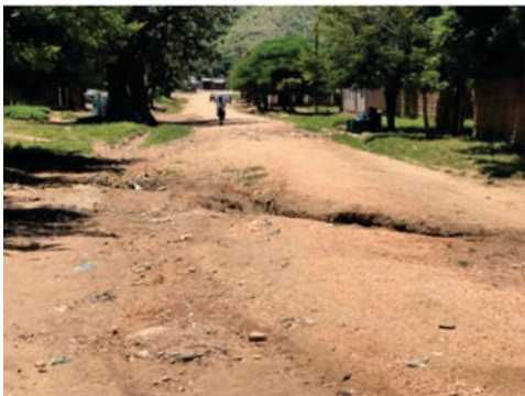
Figura 4-27: Estrada com corte transversal na plataforma devido à ausência de drenagem
