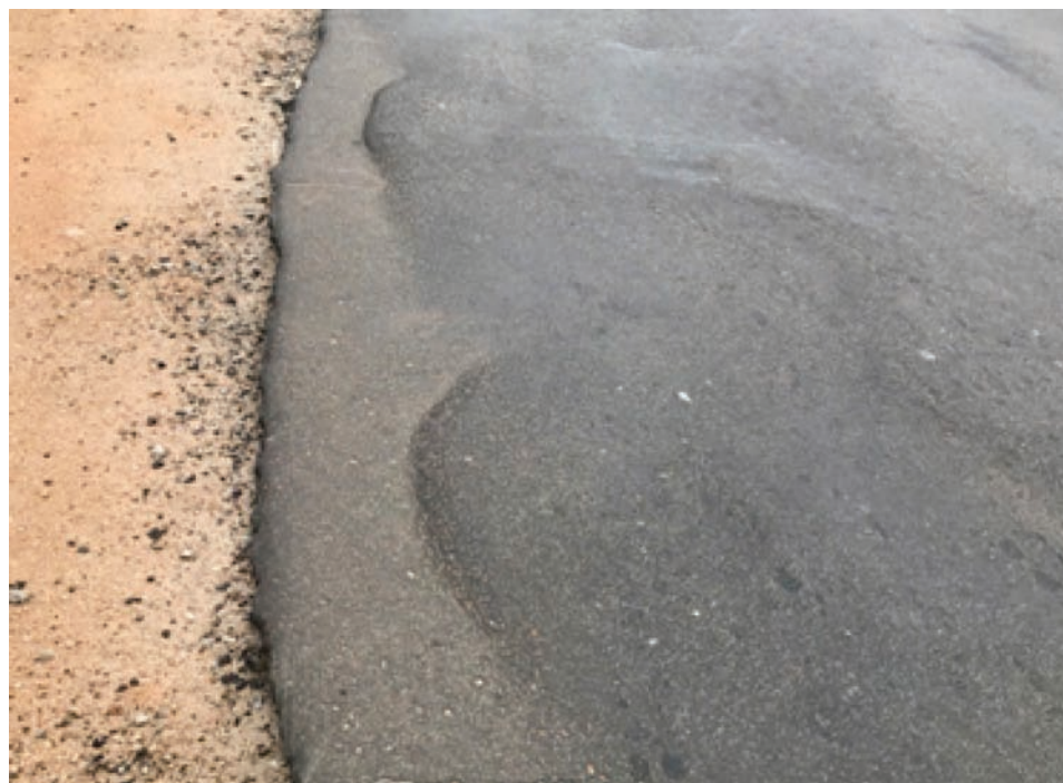
Figura 4-18: Escorregamento em massa
