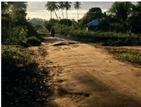
Figura 4-26: Estrada sem drenagem lateral, erosão na plataforma
