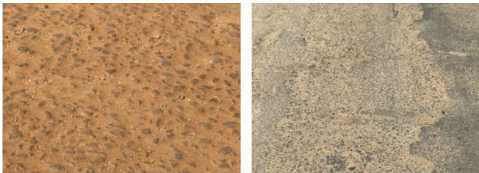
Figura 4-5: Polimento e desagregação superficial
