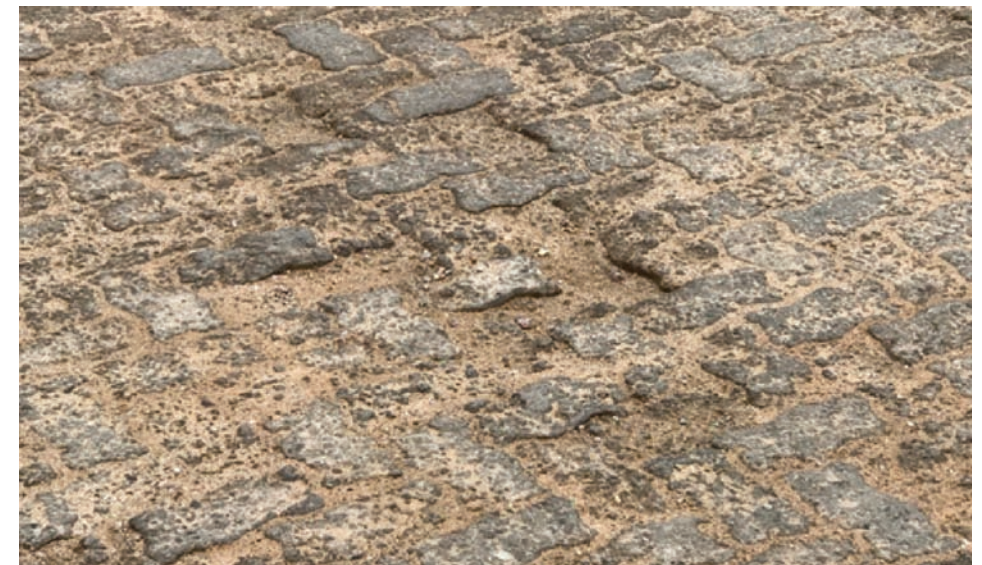
Figura 4-39: Desgaste superficial do pavê
