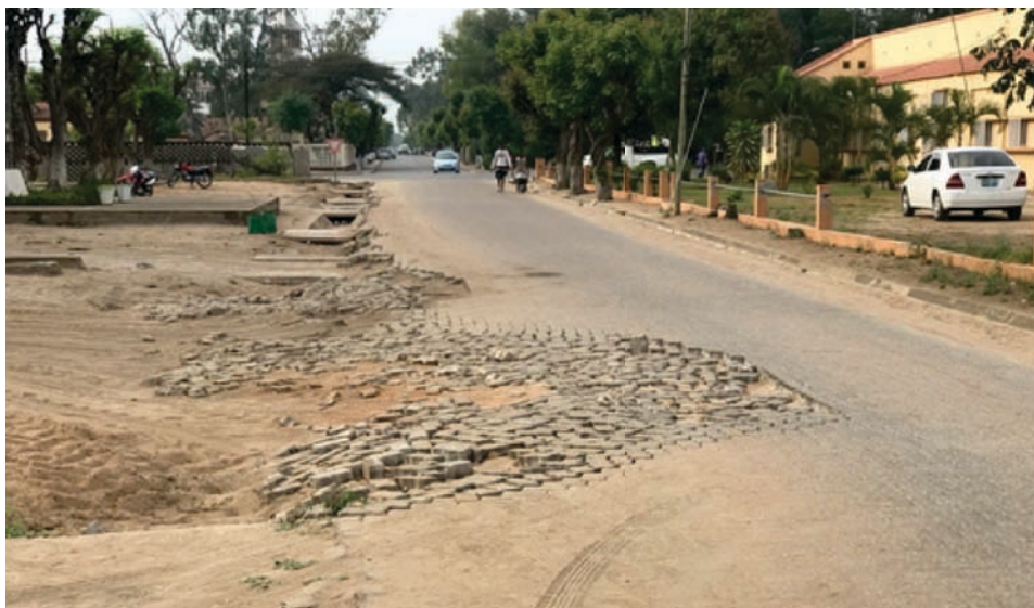
Figura 4-40: Erosão na borda dos pavimentos em pavê
