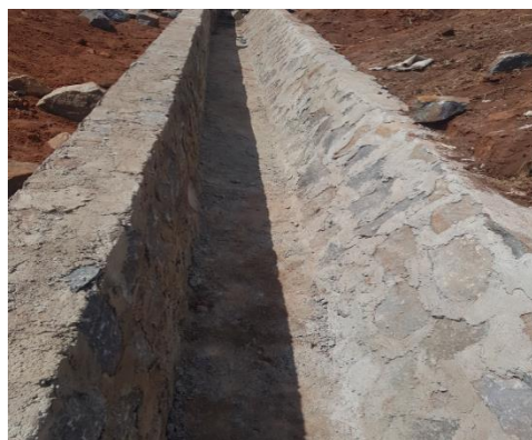
Figura 42: Vala de drenagem revestida
