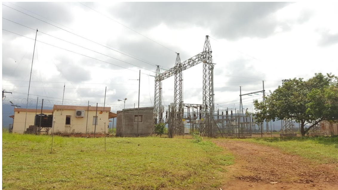
Figura 58: Central Eléctrica-110 KVA (Bairro Cooperativa)
